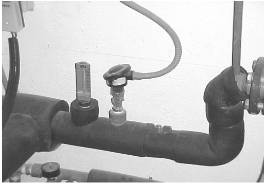
Figura 2.1. Vista d'una canonada amb aïllament.
